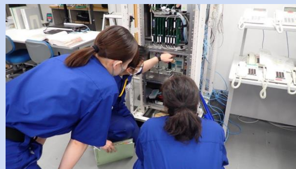
実機を用いた通信システム実習
