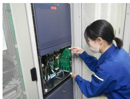
電子交換機の保守
